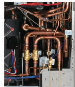
Tubería de líquido Tubería de gas
