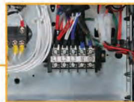
Unidad exterior terminales de alimentación trifásica
